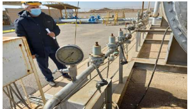
سیستم کنترل هیتر شماره ۱ (حادثه دیده)
