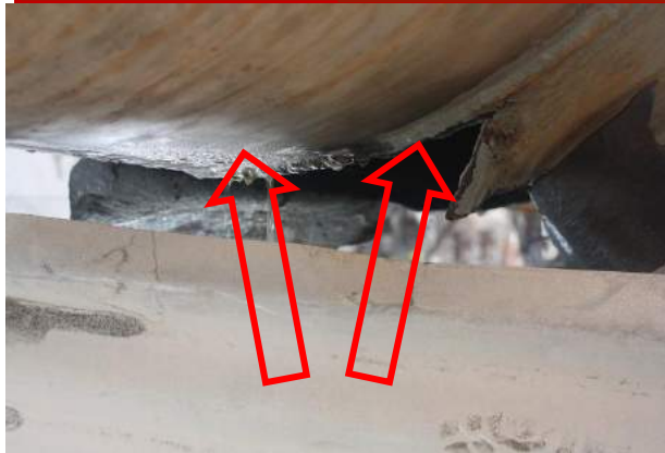
محل Rapture و نحوه گسیختگی در کنار خط جوش
