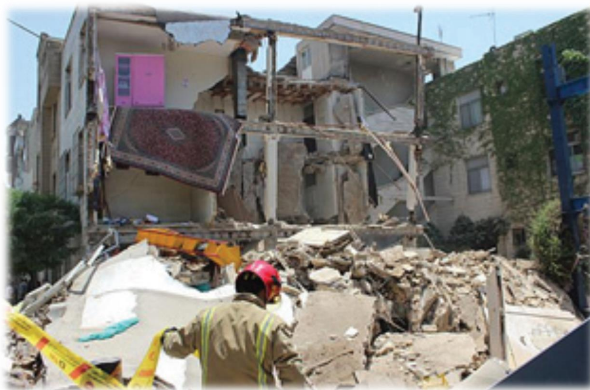
تخریب حادثه ساز
