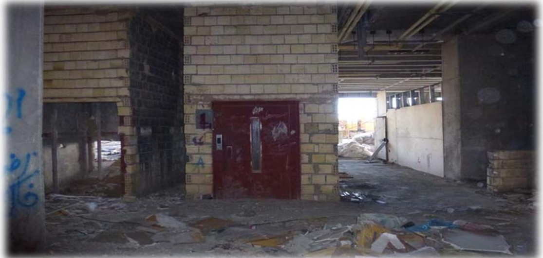
شکل ۲- آسانسورهای نفربر بلااستفاده در کارگاه
