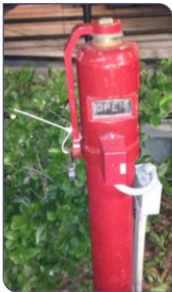
شکل ۹-۲. شیر کنترل از نوع PIV که از طریق بست زدن و اتصال الکتریکی از بسته شدن بدون اجازه آن جلوگیری شده است.
