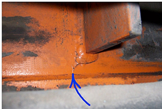
شکل ۳-۴. رشد ترک در محل اتصال فلنج به تیر اصلی
