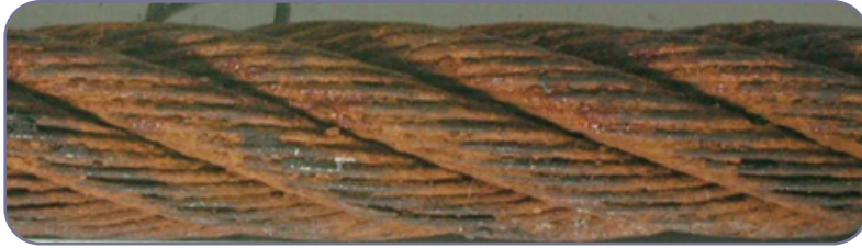
شکل ۳-۴۲. زنگ‌زدگی با سوراخ روی سطح سیم و فاصله بین سیمها (نرخ شدت آسیب ۱۰۰ درصد)
