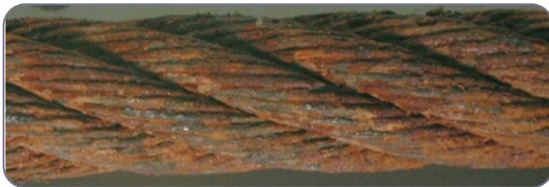
شکل ۳-۴۱. زنگ‌زدگی با سطح خشن (نرخ شدت آسیب ۶۰ درصد)
