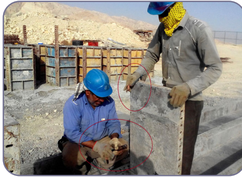
شکل ۱۱-۱. عدم استفاده از وسایل حفاظت فردی مناسب
