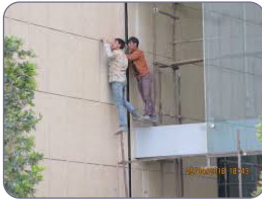
شکل ۹-۱. کار در ارتفاع بدون داربست مناسب و وسایل پیشگیری از سقوط
