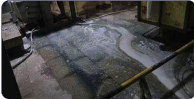
شکل ۱۴-۱. وجود مواد لغزنده در کف کارگاه
