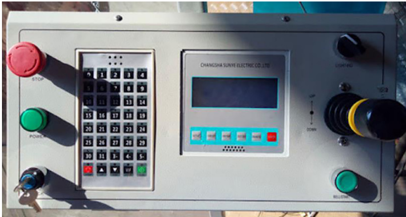
شکل ۳-۷۸. پنل کنترل و نمایشگر آسانسور کارگاهی
