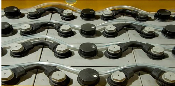
شکل ۴۵-۵: کابل‌ها و پیچ‌های اتصال سلول‌های باتری
